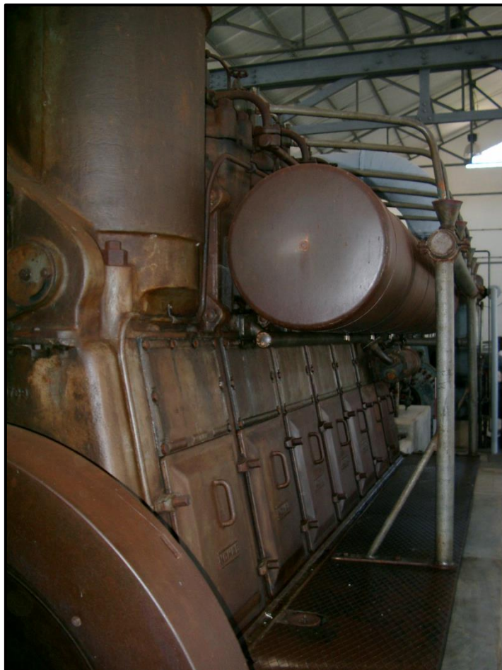
Compressor existente na central
